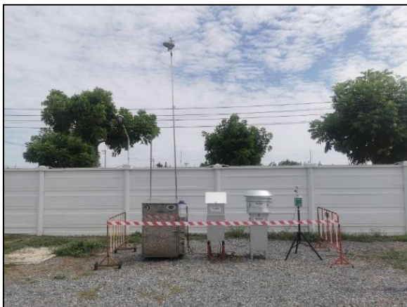
ตัวอย่างการติดตั้งสถานีการตรวจวัดคุณภาพอากาศ
